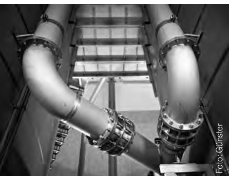
Teil der Technik im neuen Hochbehälter.
