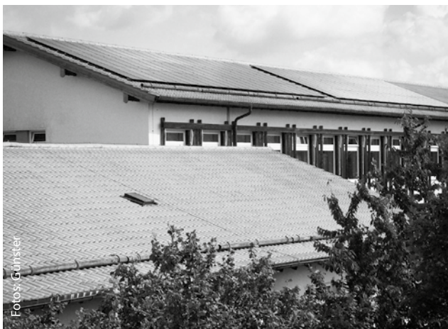
Vor 20 Jahren ist die Fotovoltaikanlage auf dem Dach der Schule montiert worden.
